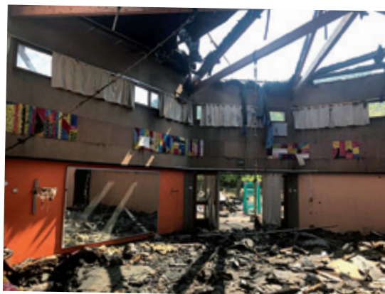
Les dégâts causés par l'incendie à l'école maternelle Le Manège
