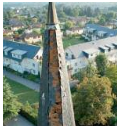
Le clocher détérioré surplombant la Villa Marthe.
