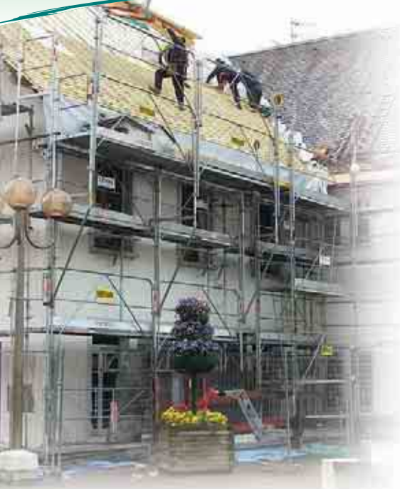
Travaux de la future Maison des Associations (rénovation en cours de l'ancienne école blanche).
